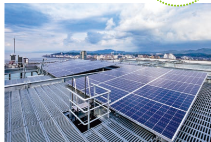
屋上のソーラーパネル
